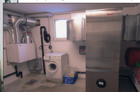
Luft-Wasser-WP im MINERGIE-Haus
