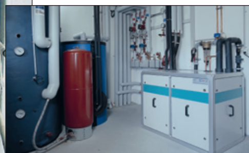
Wärmepumpenanlage im sanierten Bauernhaus in Belp
