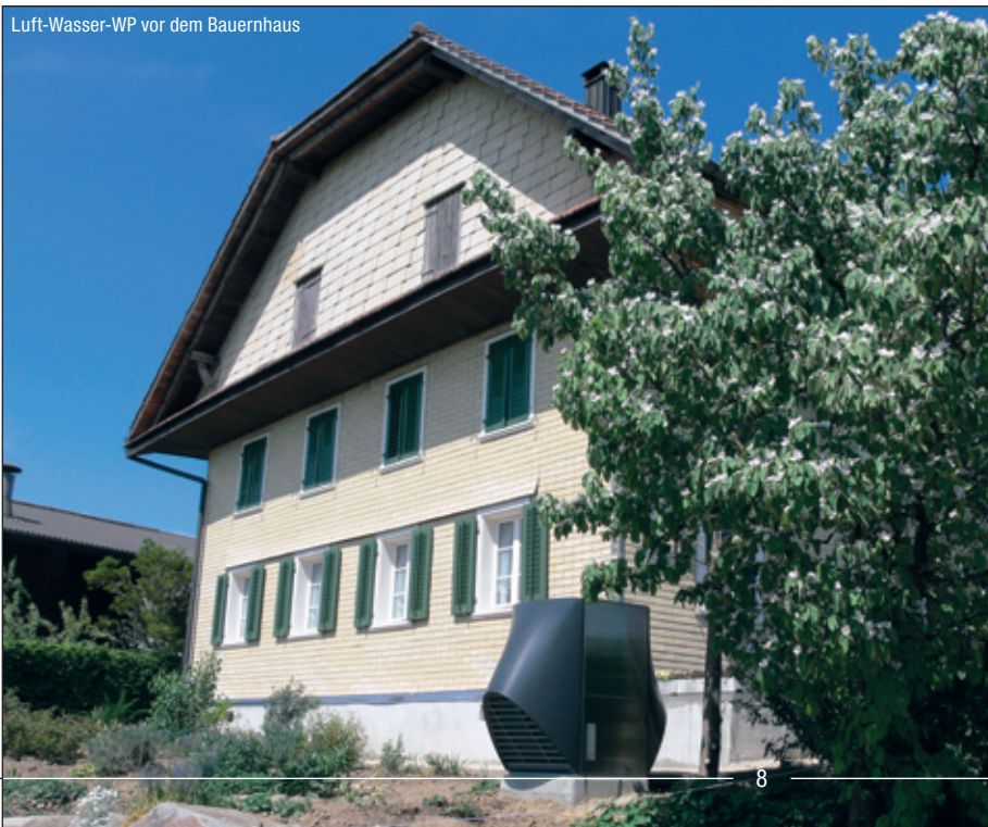
Luft-Wasser-WP vor dem Bauernhaus
