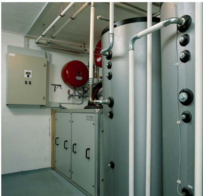
Wärmepumpe nach der Sanierung einer Elektrospeicherheizung in einem Mehrfamilienhaus
